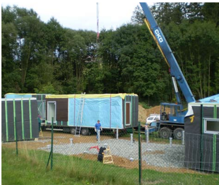
Za pomoci jeřábu začíná skládáčka budoucího domu. Čas se podle velikosti objektu počítá na hodiny, maximálně dny
